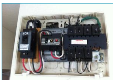
(家庭用ブレーカーBOX)
